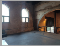
FALTA ENTRESO EXISTENTE
